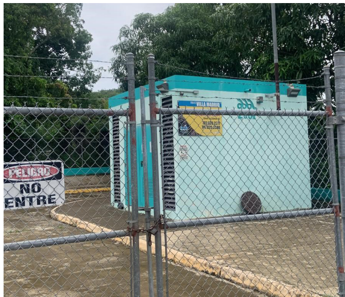
Ilustración 43. Estación de bombas de AAA en Villa Madrid y modelo sistema de bombeo con energía solar fotovoltaica
