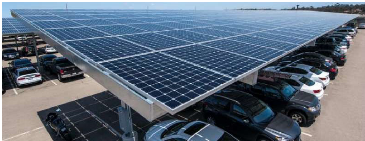
Ilustración 42. Instalación fotovoltaica en estacionamiento
