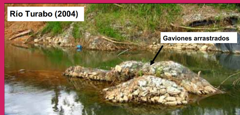
Gaviones arrastrados por la fuerza del río
