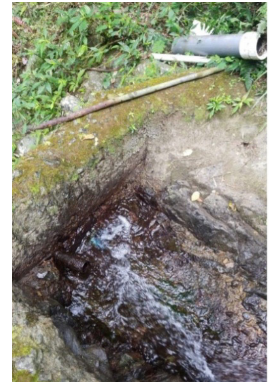
Ilustración 42. Toma de agua, tanque y caseta de bomba de clorinación de Zamas Fuente: Facebook
