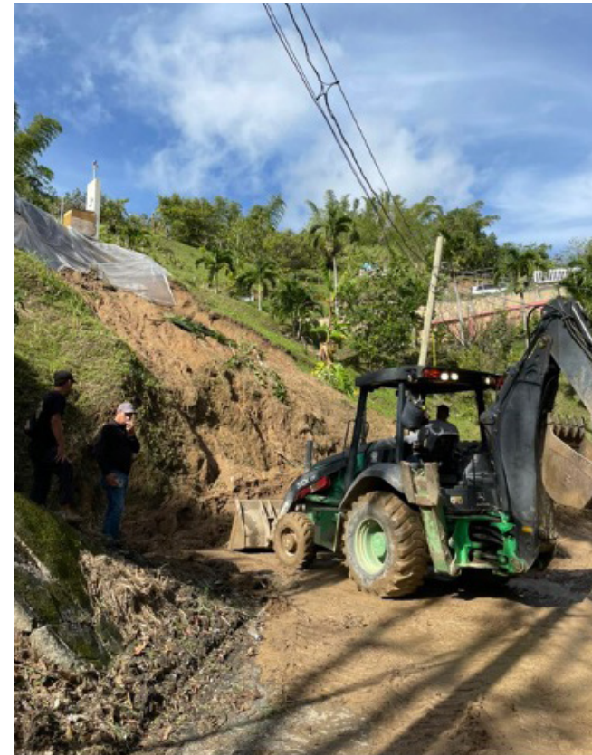
Ilustración 73. Trabajos durante y después del huracán Fiona.
